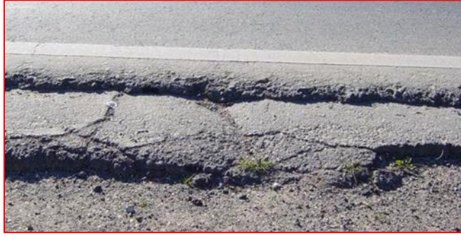
Figure: Edge Cracking
