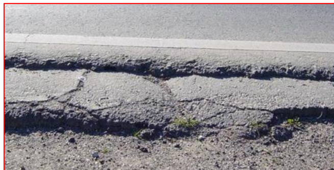
• Figure: Edge Cracking
